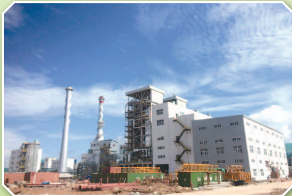
圖為本集團承建的緬甸MCL自備電站項目
